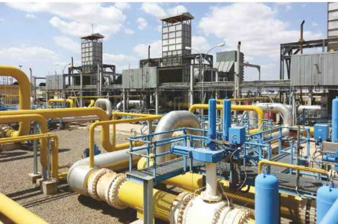
عنوان پروژه: ایستگاه تقویت فشار گاز قم نام کارفرما: شرکت انتقال گاز ایران محل پروژه: قم
